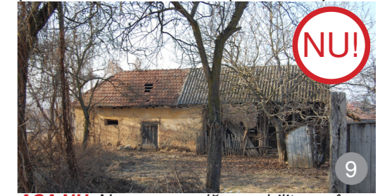
AȘA NU: Nu recomandăm reabilitarea învelitorilor din țiglă cu materiale de tip tablă.
