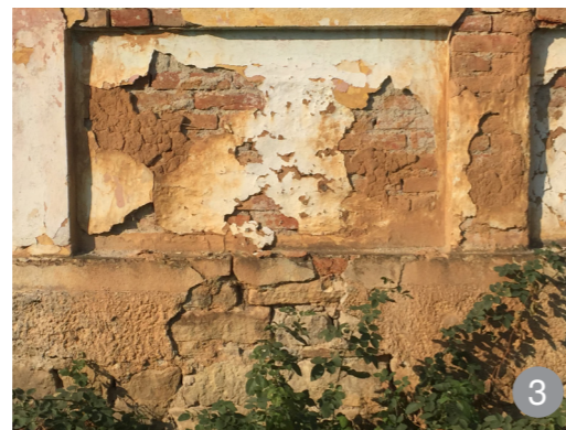
Parapet din zidărie de cărămidă muruită cu mortar de lut la târnațul unei case sălăjene
