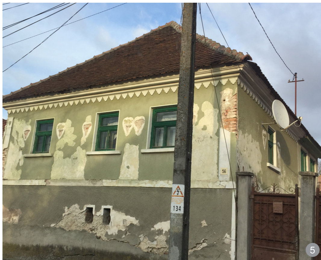
5 Decorațiile în formă de struguri de pe fațada de la stradă sunt grav degradate. În astfel de cazuri, recomandăm documentarea după fotografii sau după zone ale construcției unde detaliile au rămas intacte, dacă acestea există (aici există pe fațada laterală) pentru reconstituirea imaginii tradiționale.
