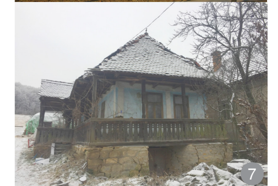
Friguriile sunt în două ape atât la casele în două ape, cât și la cele în patru ape. Frigiuriile fără fronton sunt cazuri izolate.
