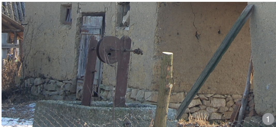
Fundație din piatră mare spartă prinsă cu mortare pe bază de pământ
