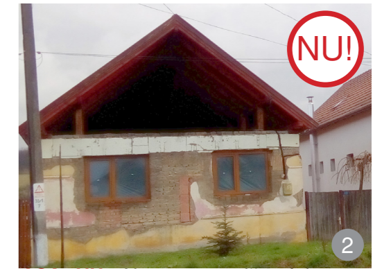
AȘA NU: Nu recomandăm înlocuirea ferestrelor vechi cu ferestre cu canaturi nespecifice zonei.
