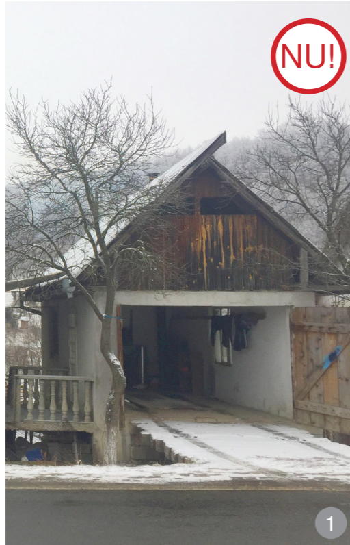
AȘA NU: Nu recomandăm construirea unor platforme de acest tip pentru accesul în garaj.
