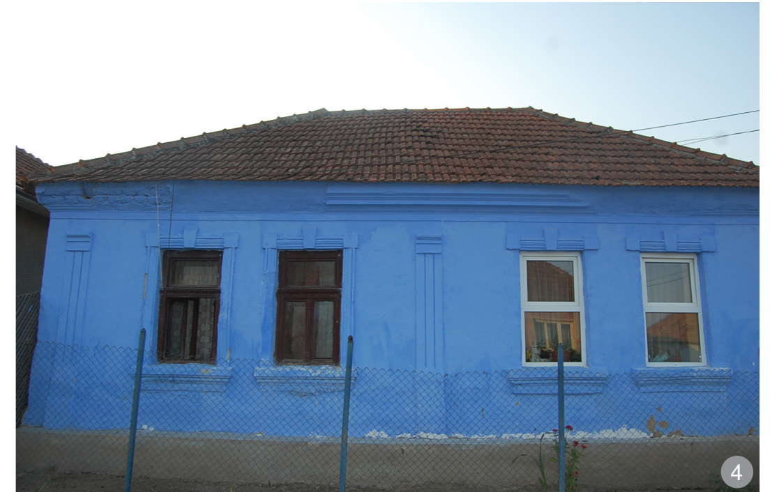
Nu recomandăm reabilitarea (stânga) cu ferestre ce nu păstrează proporția și subîmpărțirea în canaturi ale ferestrelor inițiale (dreapta) sau înlăturarea ancadramentelor decorative.
